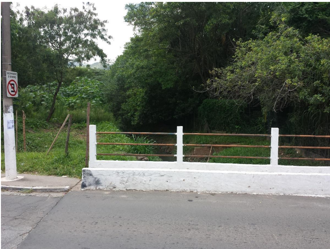
Foto 5 – Aspectos de drenagem próximo ao CT Clara Nunes
